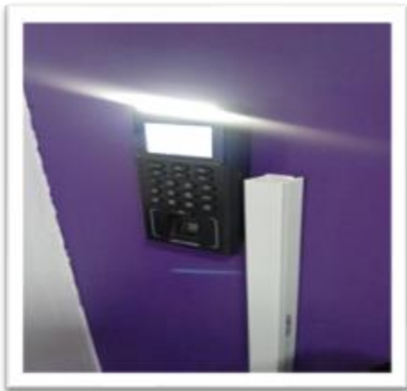
Control de Acceso Biométrico
